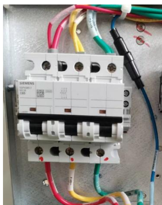
Figura 10-1 Disjuntor do Gerador HV
